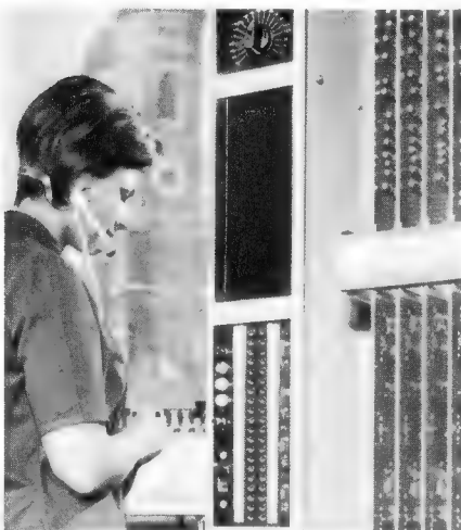
Bild 2. Routinemäßige Überprüfung der Vermittlungsstelle; rechts im Bild der elektronische Markierer, ein Teil der zentralen Steuereinrichtung der Anlage
